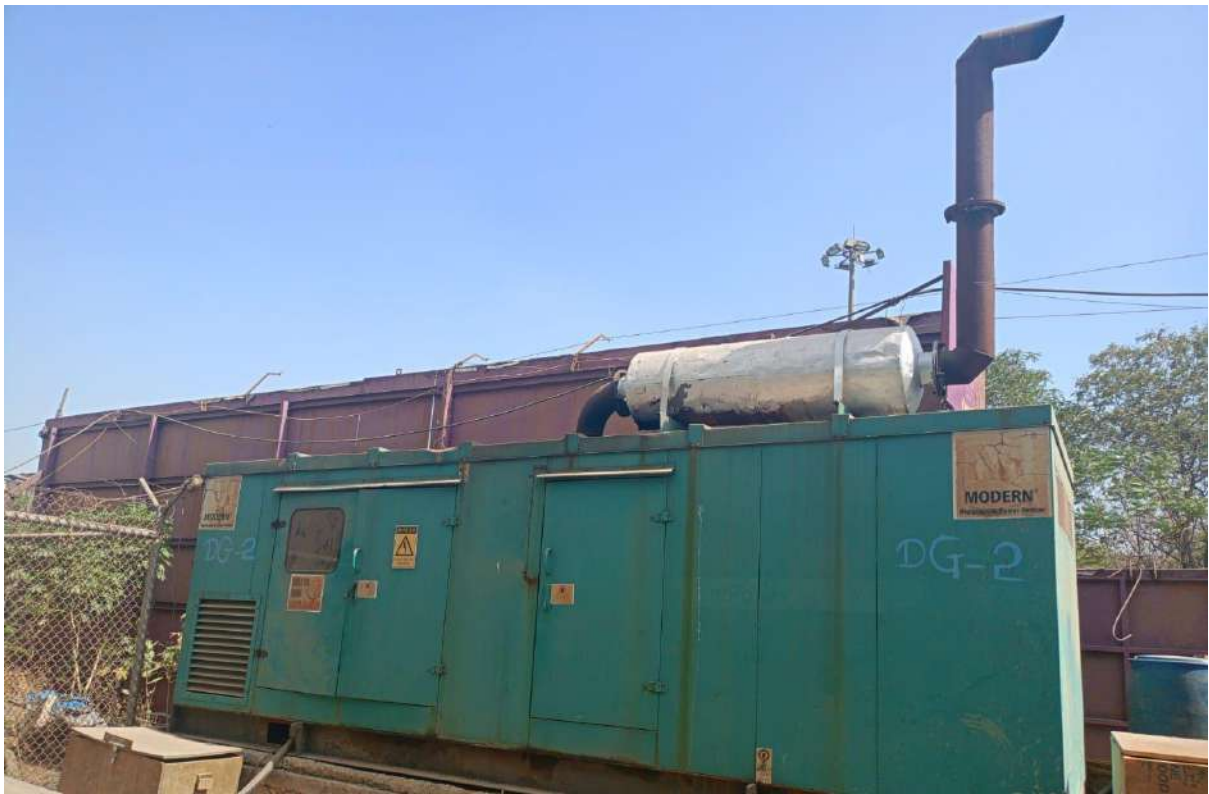
DG SET 500 KVA
